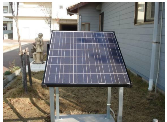
設置した太陽光パネル
