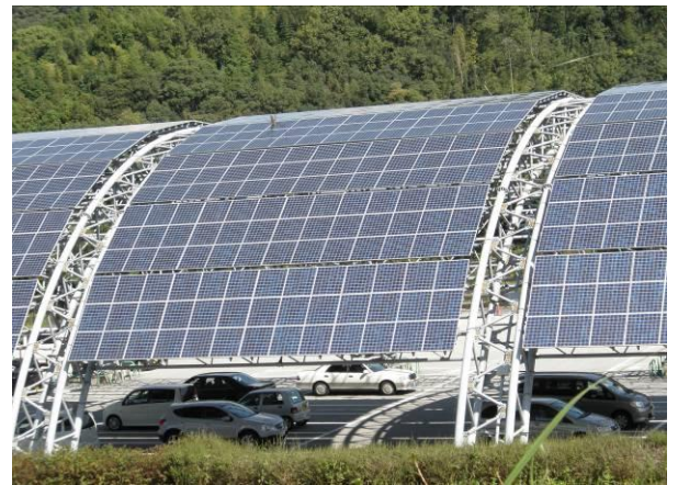
太陽光発電システム
