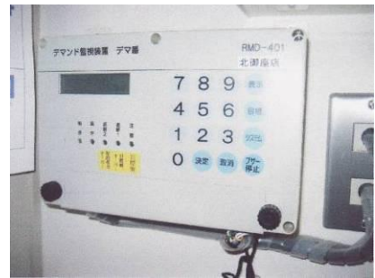
警報を発する「デマンド監視装置」
