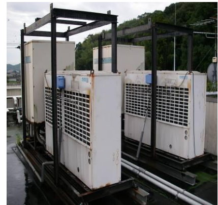
噴霧装置はすべての室外機に設置
