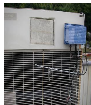
室外機に取り付けた噴霧装置
