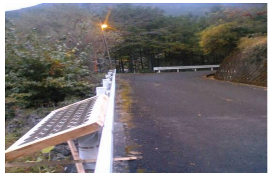
太陽光発電を利用した街路灯
