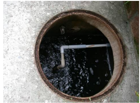
浄化槽の様子
